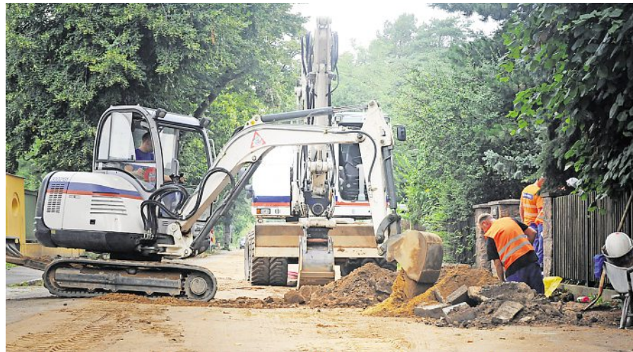
Bisher mussten die Grundstücksbesitzer auf der Friedewaldstraße in Coswig ihre Abwässer in Sammelgruben oder Kleinkläranlagen entsorgen. Nun werden sie ans Netz des städtischen Wasserversorgers angeschlossen. Foto: Anne Hübschmann
